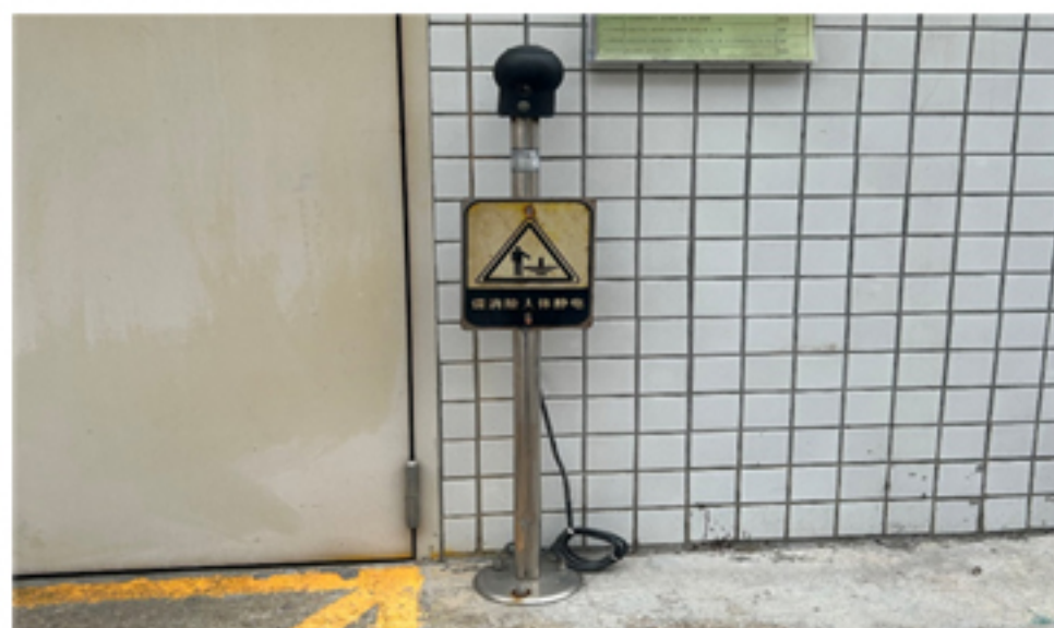
化学品仓-除静电装置
