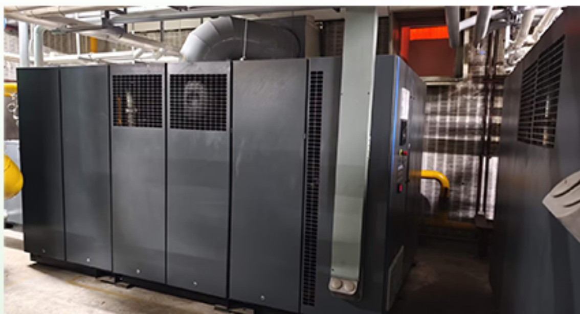
深圳崇达替换高效空压机项目
